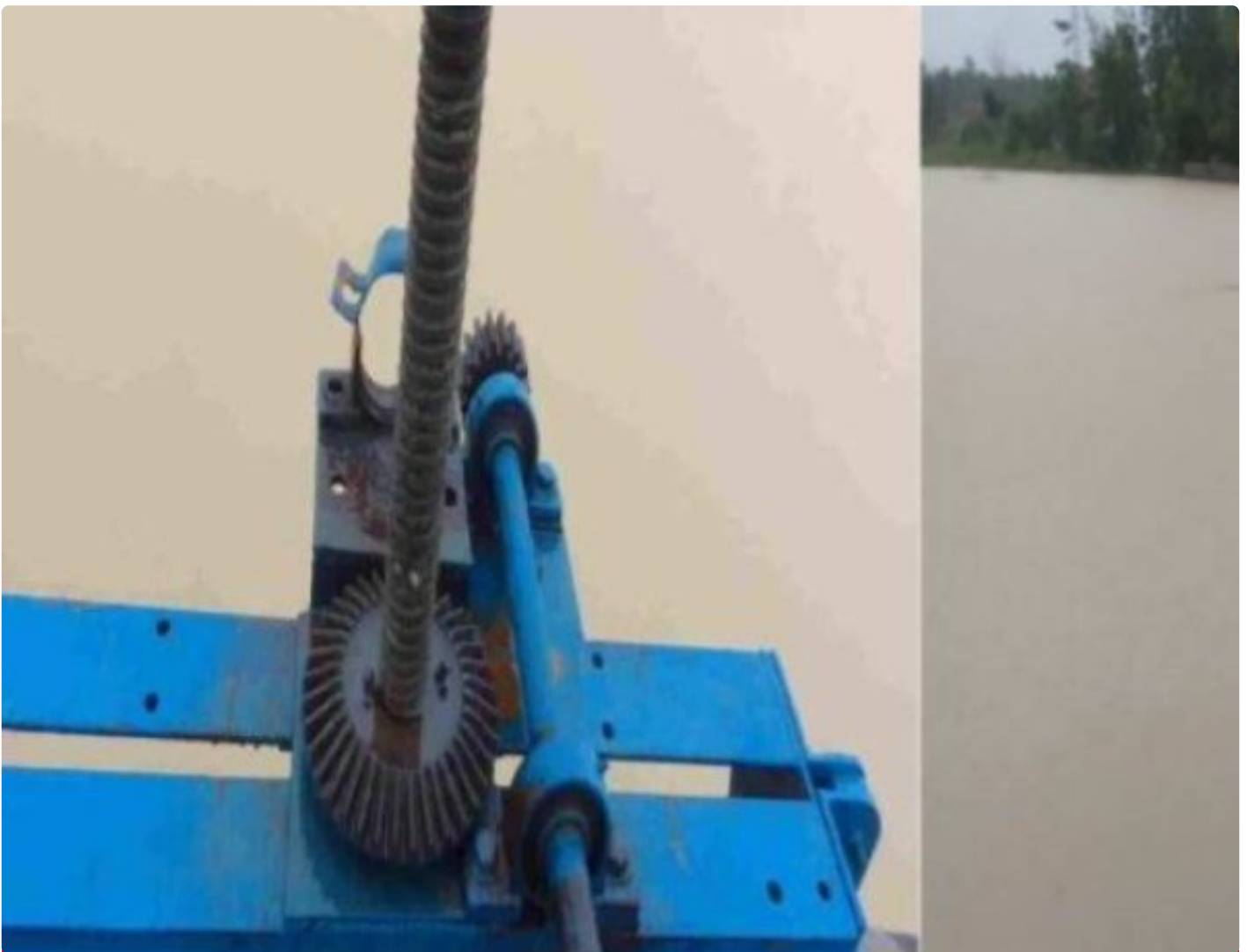
Pintu air Albaret Simpang Mesuji
